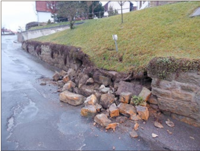
Die Einsturzstelle am Abend des 19. Januar, Foto Bauabteilung VG.
