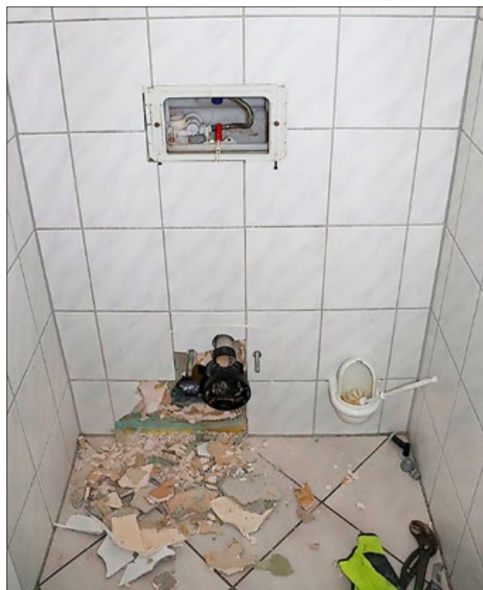
Auf der Suche nach dem Wasserschaden.
