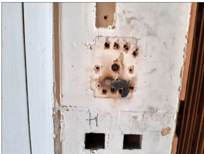
Dort, wo 59 Jahre lang der Hauptschalter für den Winderzeuger saß, sind nicht nur eine Vielzahl von Bohrungen erkennbar, sondern auch leicht angesengtes Holz.
