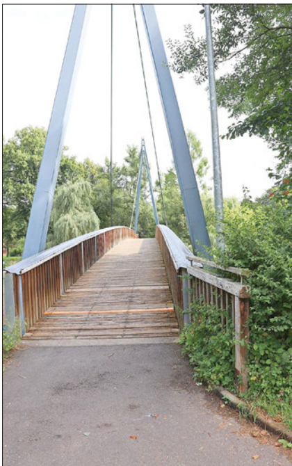
Für die Sanierung des Ebenshäuser Steges ist ein Antrag auf Förderung gestellt. Die Stadt hofft bei positiven Bescheid auf einen Baubeginn 2023.
