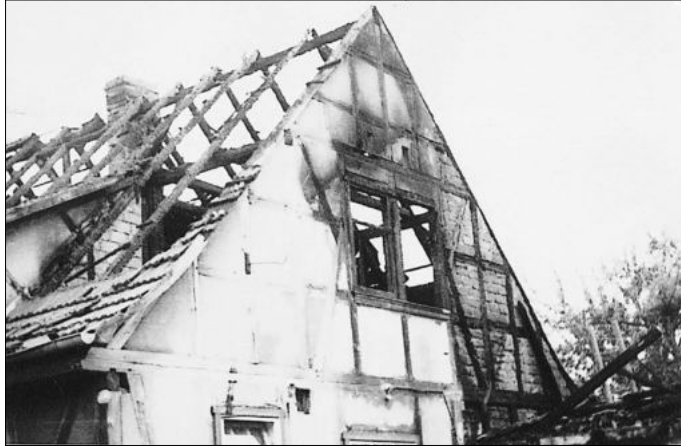
Dachstuhl des Wohnhauses Schloßstraße 1 nach dem Brand vom 16. Juni 1964
