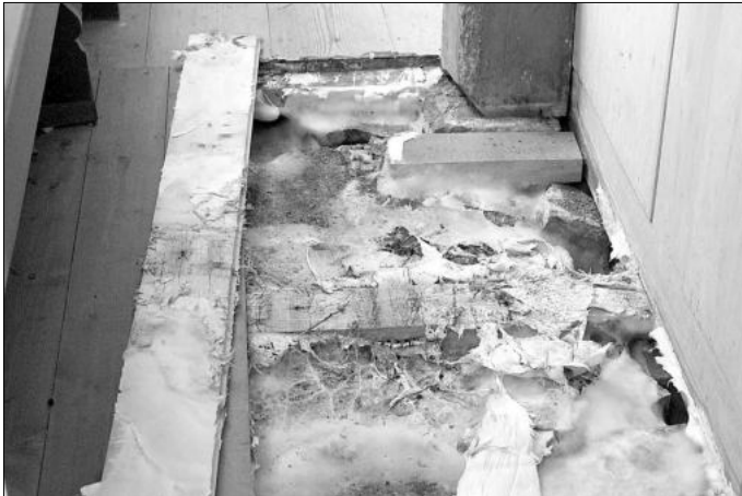
So zeigte sich der Echte Hausschwamm unter den Dielen des Altarraumes im Mai 2018. Mehrjährige Sanierungsarbeiten waren die Folge.
