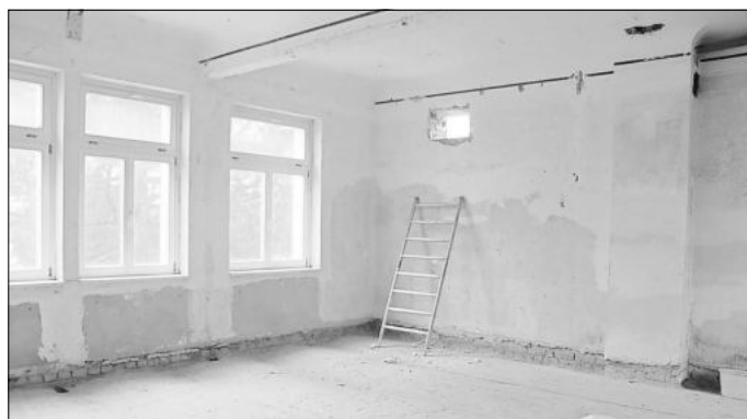
Der alte Schulraum, zuletzt Gaststättenraum, ist als Voraussetzung für den Umbau völlig entkernt.
