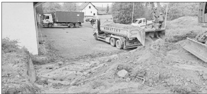
Baubeginn bei der Mihlaer Feuerwehr. Die Bodenplatte für eine neue Seitengarage soll noch in 2023 fertig werden.
