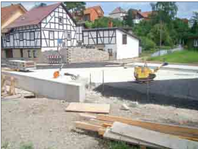
Noch fehlen die „Feinarbeiten“ an der Brücke, das Anpflastern, Geländer, ehe die Verkehrsfreigabe erfolgen kann.
